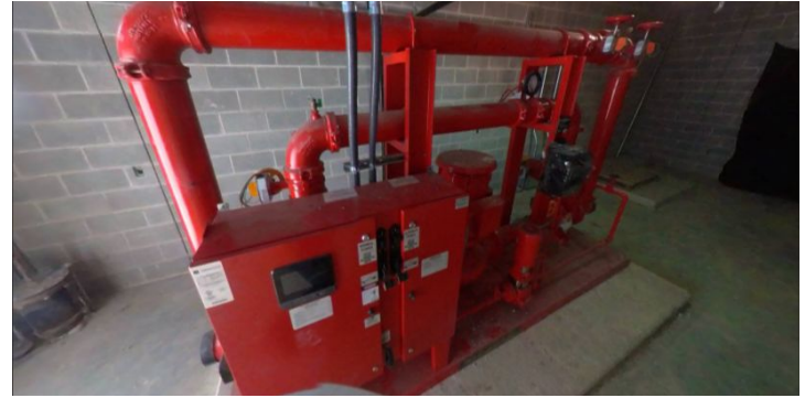
Salón de bombas de rociadores
