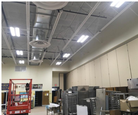
Distribution d'air de la cafétéria, éclairage LED et système d'arrosage
