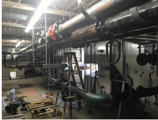
Tuyauterie de distribution de chauffage/refroidissement hydronique et unités de traitement de l'air
