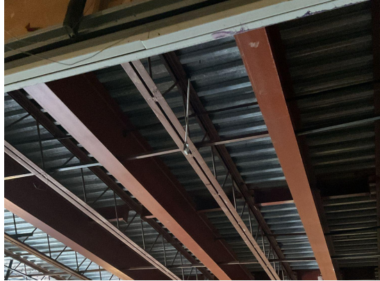
Supports en acier de construction pour équipements montés sur toit
