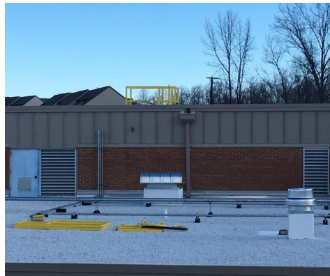
Ventilateurs d'extraction montés sur le toit, évents par gravité et rails de sécurité
