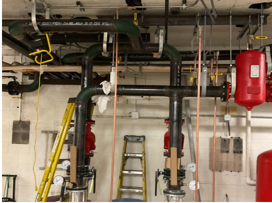
Tuyauterie de distribution de chauffage/refroidissement hydronique et stations de pompage
