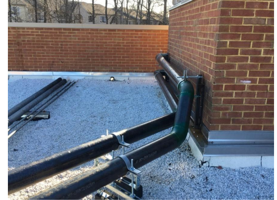
Tuyauterie de distribution de refroidissement hydronique montée sur le toit
